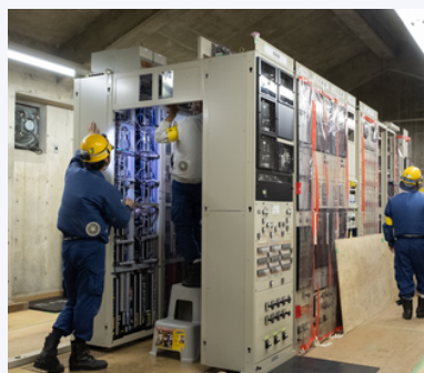
据付後の制御盤
